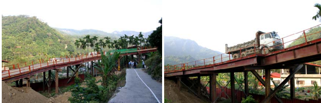
C607 標斗山高架橋施工便道跨越產業 C607 標斗山高架橋施工鋼棧橋道路
